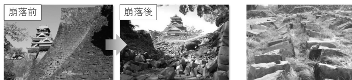
図1 崩落前後の熊本城の石垣と石置き場に移動された崩落石材
