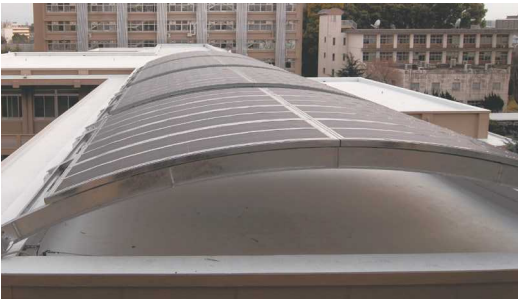
工学部屋上に設置されたソーラーアーチ
