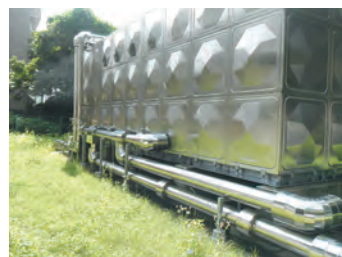
受水槽(井水を貯めています)
