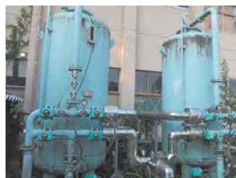
ろ過装置(井水をろ過しています)
