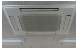
空調機取替後▶
