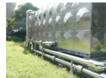
受水槽(井水を貯めています)
