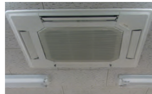
空調機取替後▶
