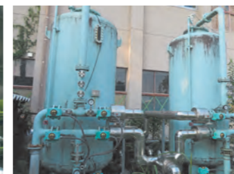
ろ過装置(井水をろ過しています)
