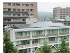
共用棟黒髪2 26kW
