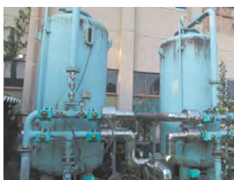
ろ過装置(井水をろ過しています)
