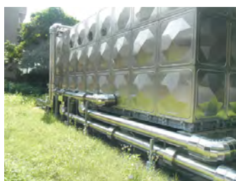
受水槽(井水を貯めています)
