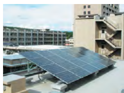
工学部研究棟IV 5kW
