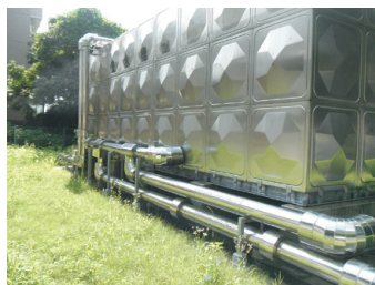
受水槽(井水を貯めています)
