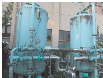
ろ過装置(井水をろ過しています)
