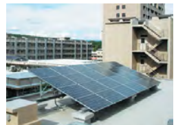
工学部研究棟Ⅳ 5kW
