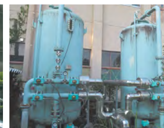
ろ過装置(井水をろ過しています)
