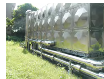
受水槽(井水を貯めています)
