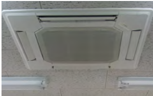
空調機取替後▶
