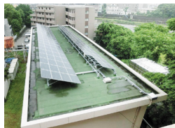
水理実験棟 30kW
