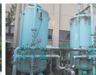
ろ過装置(井水をろ過しています)
