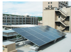
工学部研究棟IV 5kW
