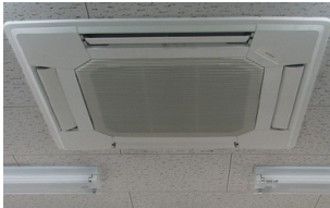
空調機取替後▶
