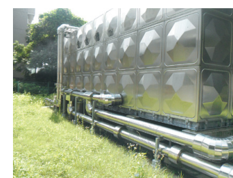
受水槽(井水を貯めています)
