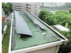
水理実験棟 30kW
