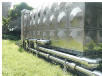
ろ過装置 (井水をろ過しています)
