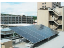
工学部研究棟IV 5kW
