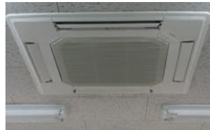
空調機取替後▶
