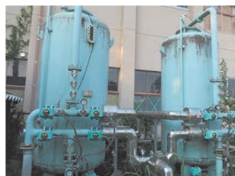
受水槽 (井水を貯めています)
