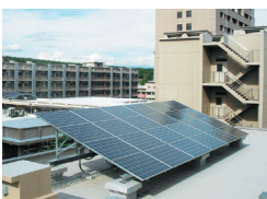
工学部研究棟IV 5kW
