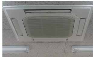
空調機取替後▶
