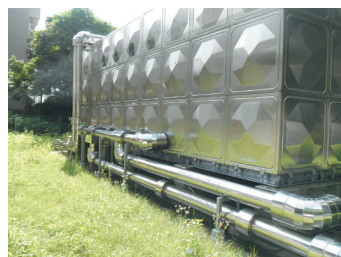
ろ過装置(井水をろ過しています)
