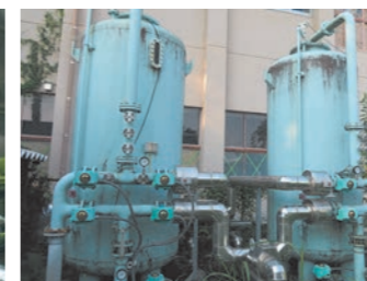
受水槽(井水を貯めています)
