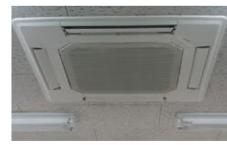
空調機取替後▶
