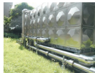
ろ過装置(井水をろ過しています)
