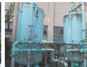
受水槽(井水を貯めています)
