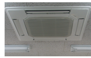
空調機取替後▶
