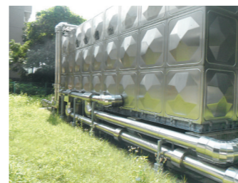
ろ過装置(井水をろ過しています)
