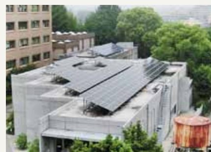
学生食堂 (FORICO) 屋上 30kW
