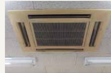
空調機取替前
