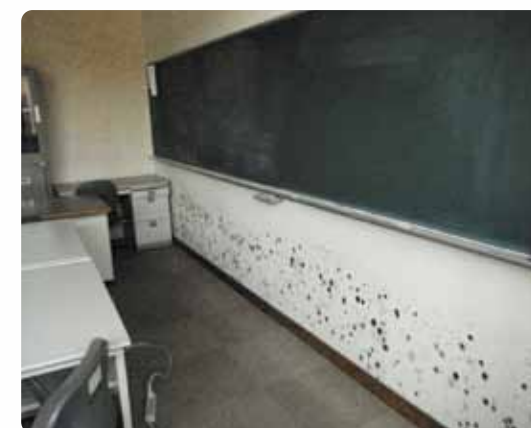
漏水によりカビが発生
