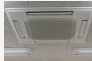
空調機取替後
