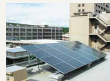
工学部研究棟Ⅳ 5kW
