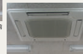
空調機取替後
