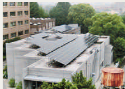
学生食堂 (FORICO) 屋上 30kW
