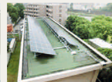
水理実験棟 30kW
