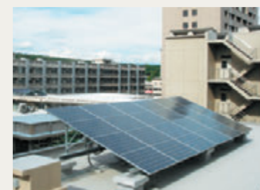
工学部研究棟Ⅳ 5kW
