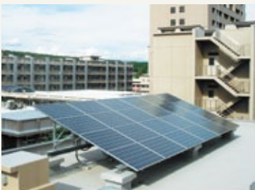
工学部研究棟Ⅳ 5kW
