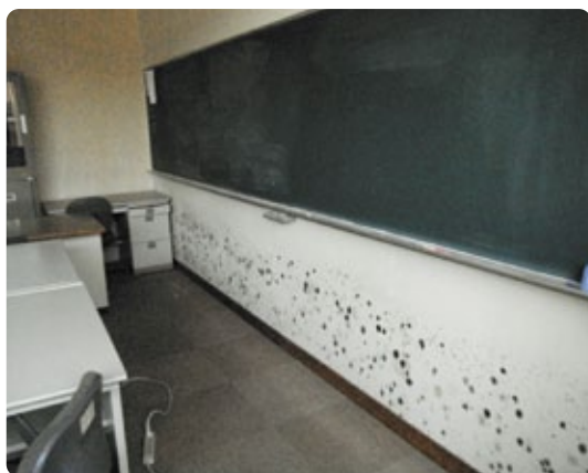
漏水によりカビが発生
