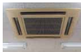
空調機取替前
