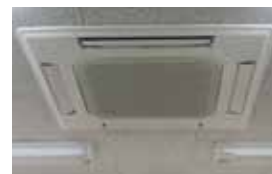
空調機取替後
